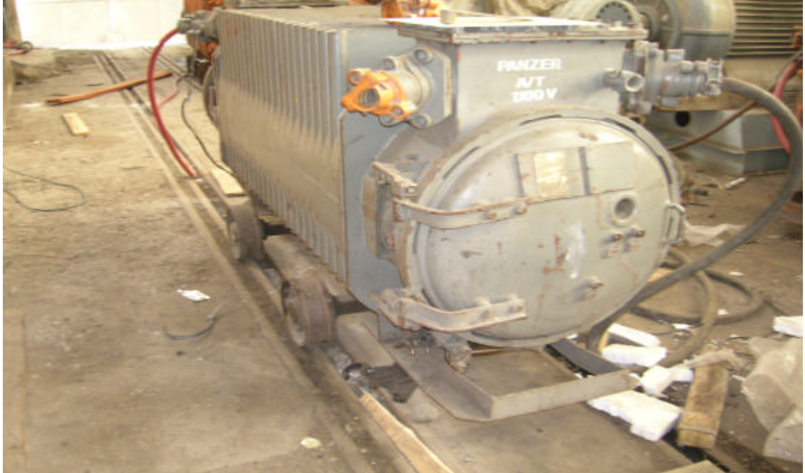
Transformadores fuera de servicio. Año 2007.
