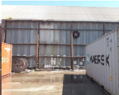
Pared circundante con roturas
