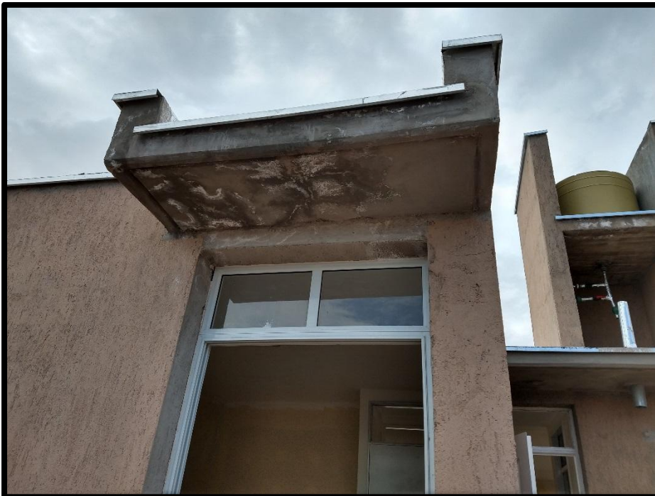
Foto 4: B° La Esperanza. Eflorescencias en losa de hormigón.
