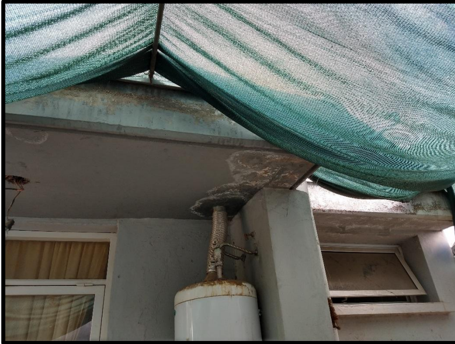
Foto 3: B° San Antonio. Eflorescencias en losa de hormigón. Sector lavadero.
