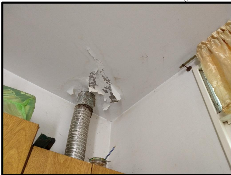
Foto 2: B° San Antonio. Registros de ingreso de agua en coincidencia con el ducto de ventilación sector cocina.
