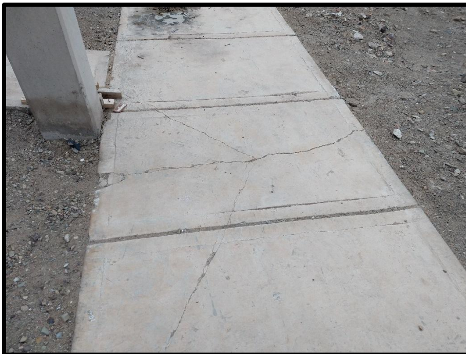
Foto 1: B° Solares de Pedemonte. Fisuras en las veredas de hormigón nuevas.
