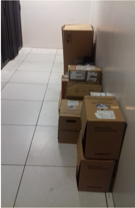
Fotografía N° 5, material inflamable dentro del CPD
