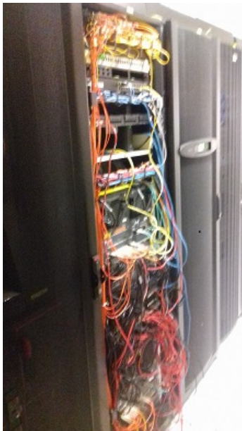
Fotografía N° 6, cableado sin un tendido normalizado ni documentado
