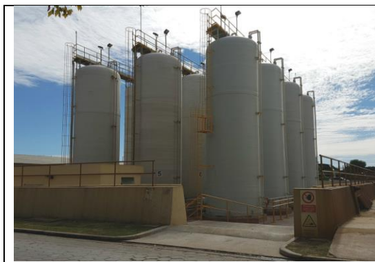
Depósitos de coagulante
