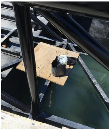
Foto 11: Trabajos de pintura sin bateas de contención, Puerto Frías.
