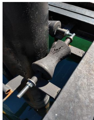
Foto 2: Rodillo a ser reemplazado por la contratista. Puerto Blest.
