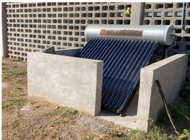
Foto 5: Termotanque solar instalado al nivel del suelo y a la sombra.
