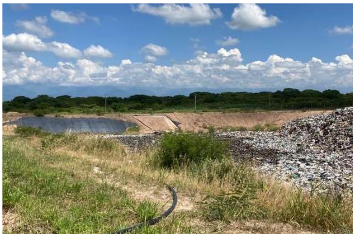
Foto 8: Membrana geotextil expuesta en el talud del relleno sanitario en el CAJ.
