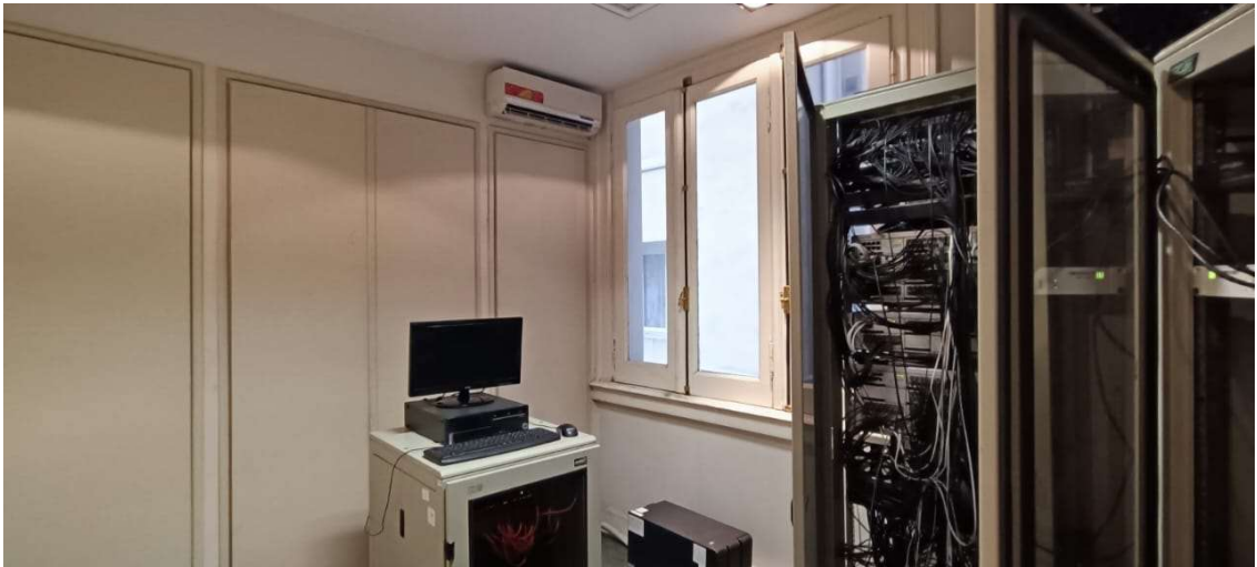
Fotografías N°3 y N°4 – Estado de las instalaciones en el interior de la Sala de Servidores
