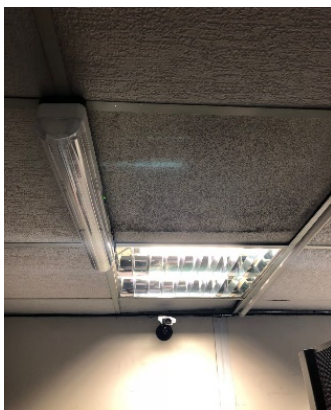
Fotografía N° 5, placa de techo suelta/sin fijación
