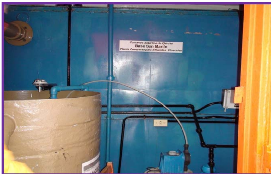
Planta de tratamiento de efluentes cloacales
