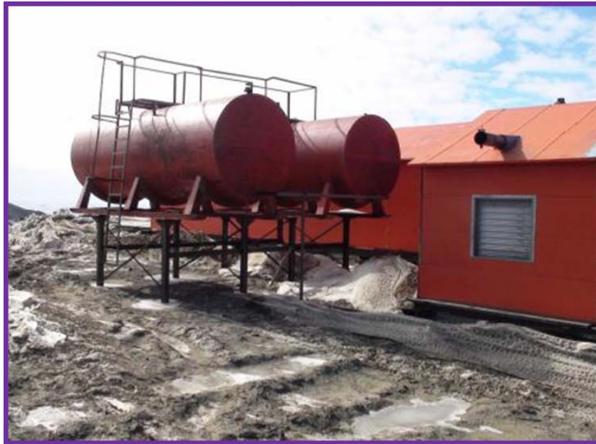
Combustibles para la calefacción
