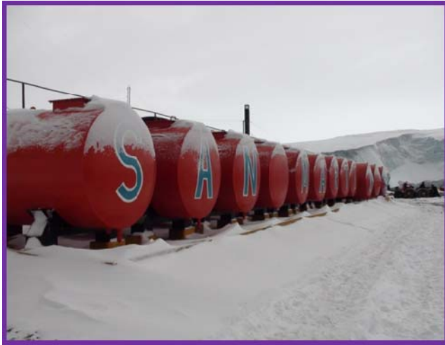
Batería de tanques aéreos de combustible
