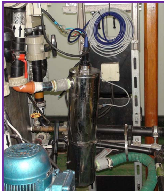
Lámpara de UV de la planta de tratamiento de efluentes cloacales. Base Carlini
