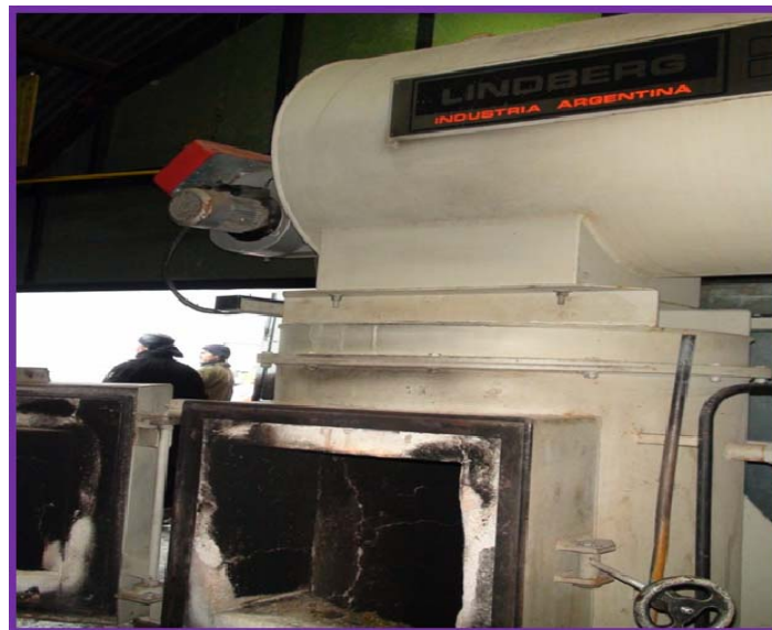
Incinerador de residuos
